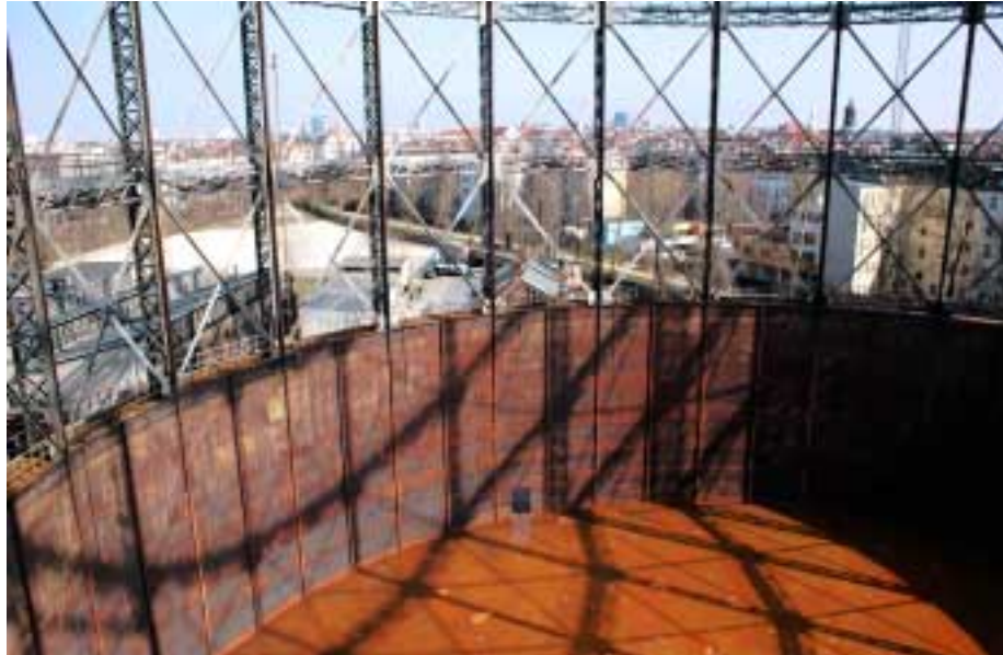
Der Gasometer wartet vor sich hinrotend auf seine Sanierung
